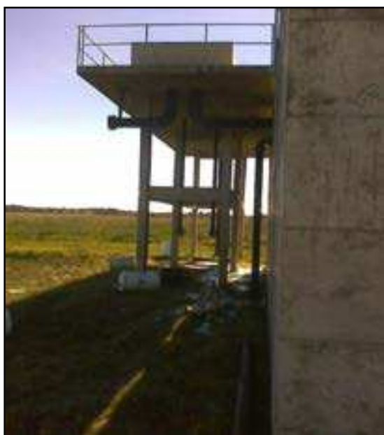
Figura 26 – Desarenador (Fonte STE)
