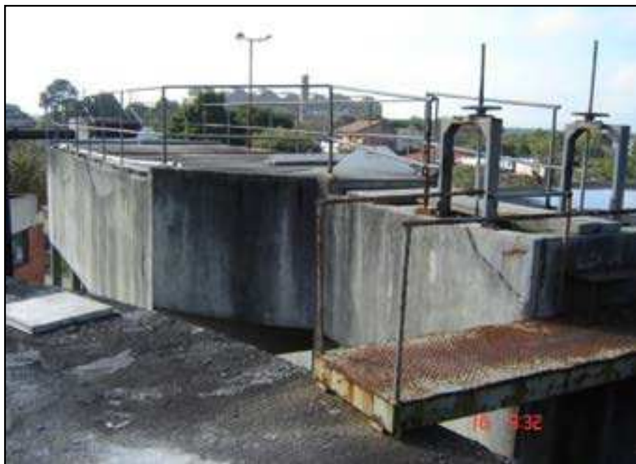
Figura 17 - Desarenador e calha Parshall (Fonte STE)
