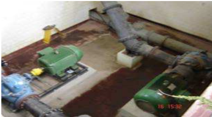
Ilustração 17– Conjuntos motobombas: Para a rede de 500 mm (esquerda); Para a rede 450 mm (direita)
