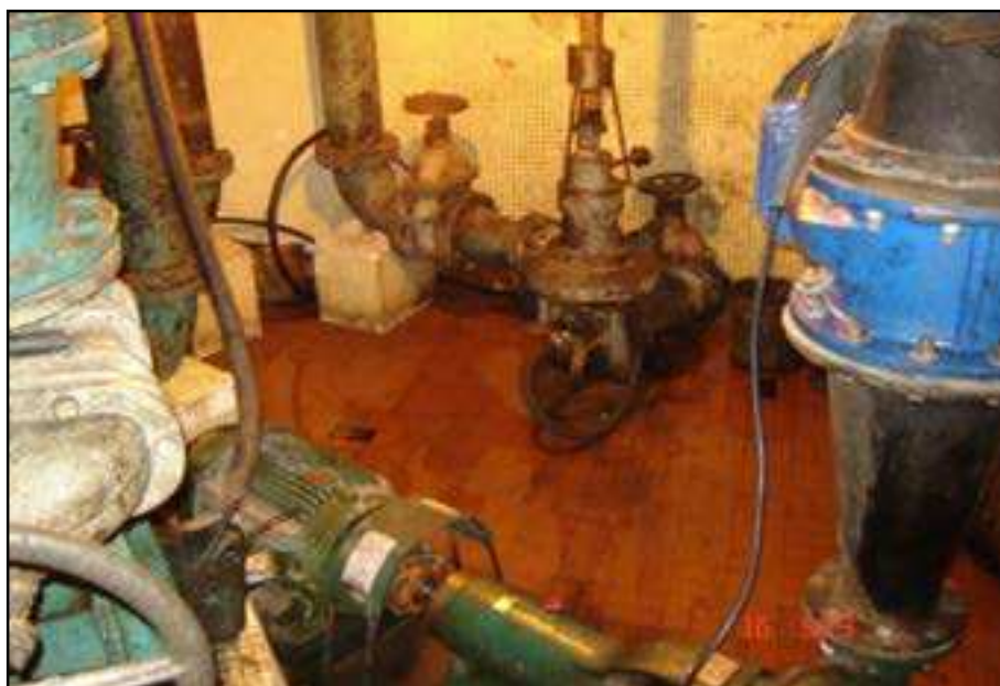
Figura 14 - Vista dos conjuntos moto-bomba no subsolo (Fonte STE)
