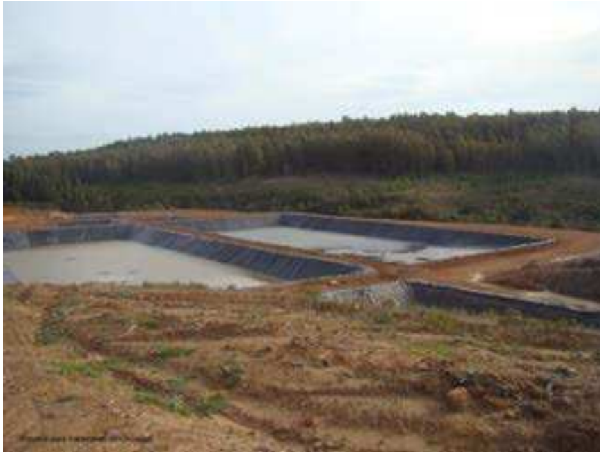
Figura 3.43 – Lagoas de estabilização para tratamento dos lixiviados
