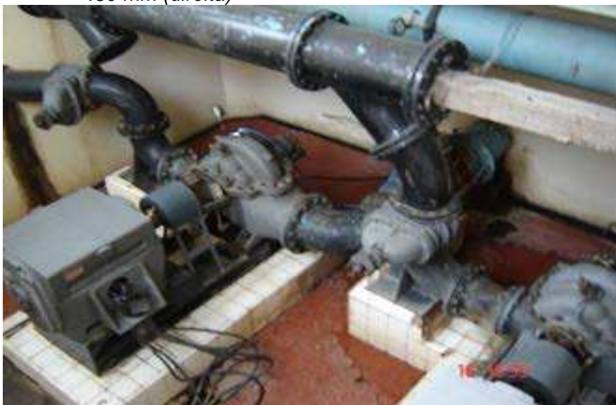
Ilustração 18 - Vista dos conjuntos motobomba 300 mm
