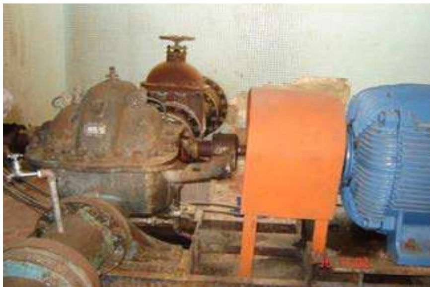
Ilustração 32- Conjunto motobomba 4ª EEAT
