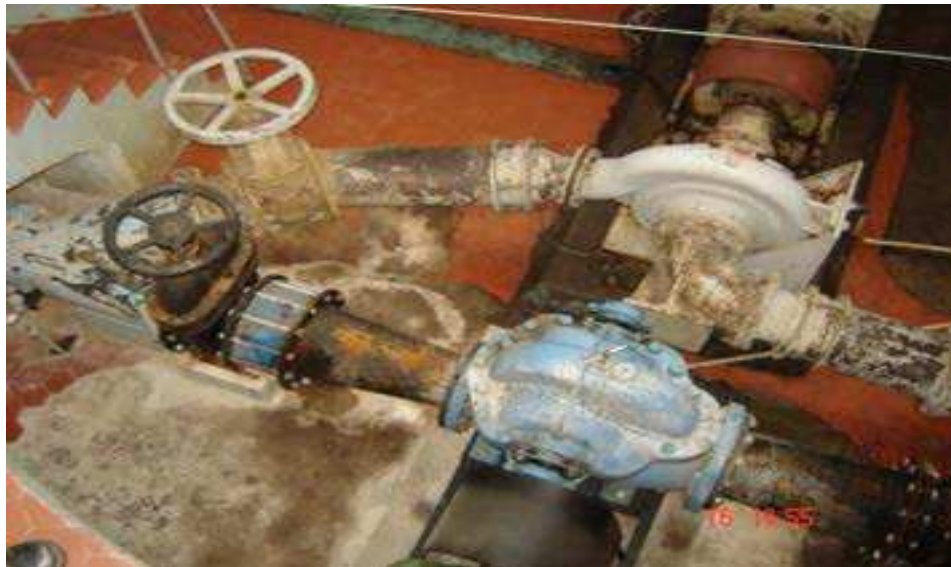
Ilustração 31 - Conjunto motobomba 3ª EEAT
