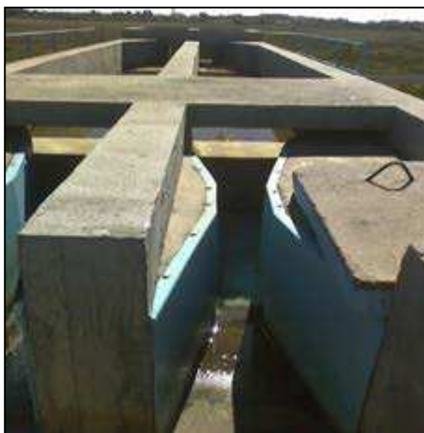
Figura 27 - Calhas Parshall (Fonte STE)
