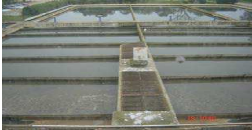
Ilustração 37 – Vista geral dos 06 decantadores da 1ª etapa
