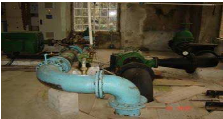
Ilustração 13 - Motores, bombas, tubulação e poço de sucção
