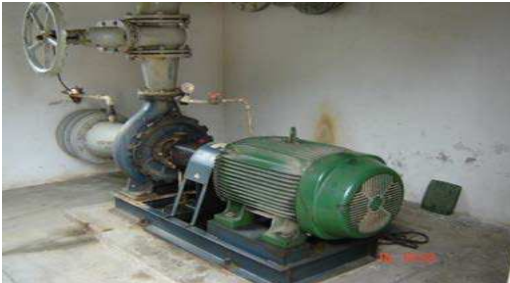
Ilustração 29 - Conjunto motobomba 1ª EEAT
