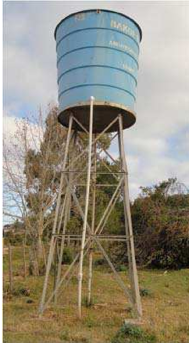
Ilustração 021 – Primeira caixa d'água abastecida pelo MB-3, servindo, também, como amortecimento de energia da água. Possui capacidade de 10.000 litros e tubulações de entrada e saída com mesmo diâmetro, ambas DN 50.
