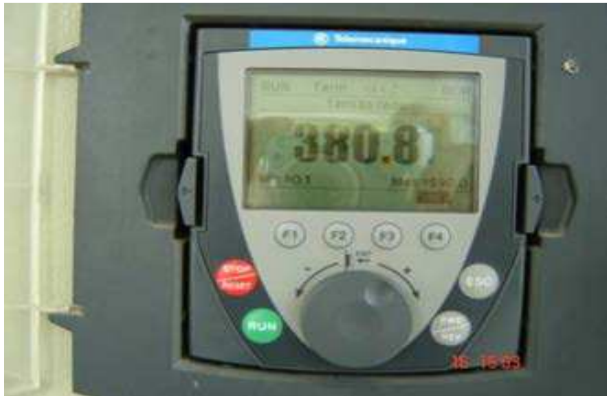
Ilustração 33 - macro medição adutora 4ª EEAT
