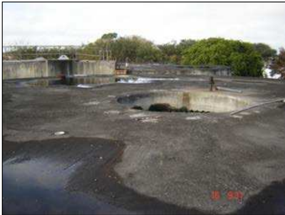
Figura 19 - Vista superior dos reatores (Fonte STE)
