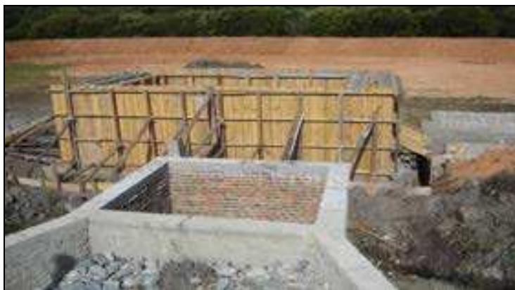
Figura 3.2 – Construção de caixa de passagem e filtro anaeróbio para o sistema de tratamento de lixiviado
