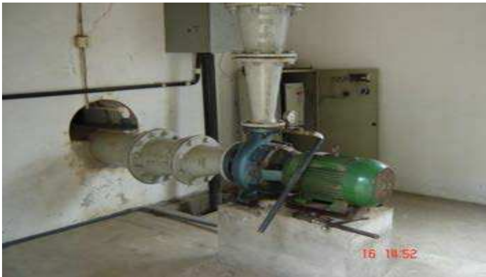
Ilustração 30 - Conjunto motobomba 2ª EEAT
