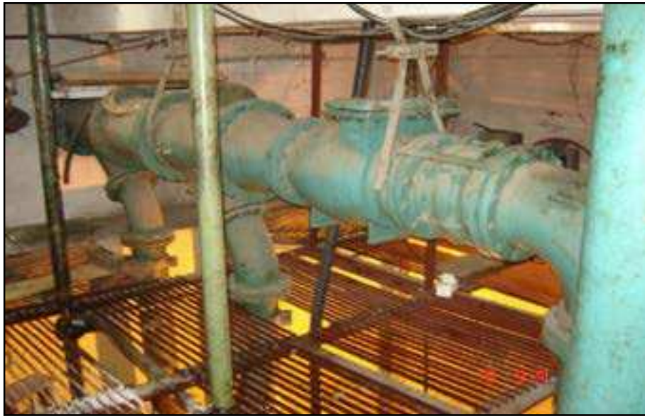
Figura 13 - Barrilete de recalque (Fonte STE)
