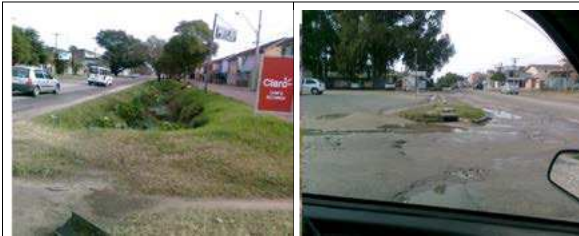
Figura 23: Avenida Salgado Filho, ponto crítico de alagamento.
