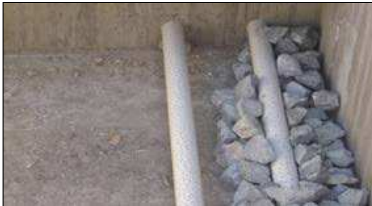
Figura 3.4 – Detalhe do filtro anaeróbio em fase construtiva. No detalhe observam-se os tubos perfurados
