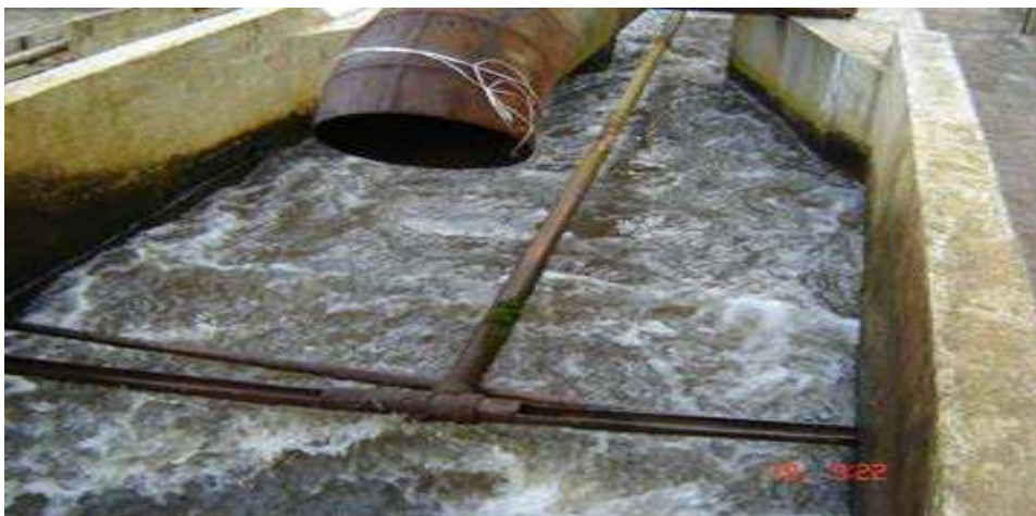
Ilustração 36 - Chegada de água bruta na calha de medição (1ª etapa)
