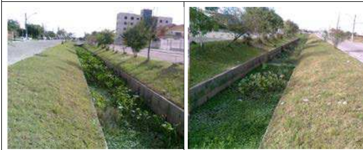
Figura 21: Avenida São Francisco de Paula, ponto crítico de alagamento.
